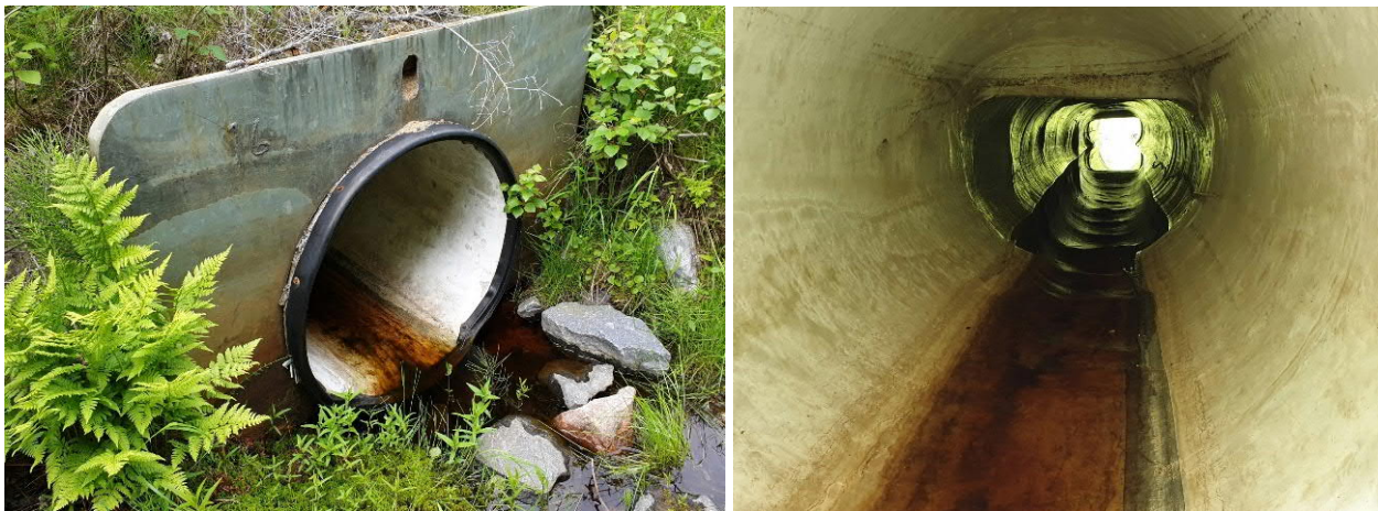
Figur 3: Utsida och insida av relinad trumma. Den lägre hjässan på insidan av trumman syns i den högra bilden.
