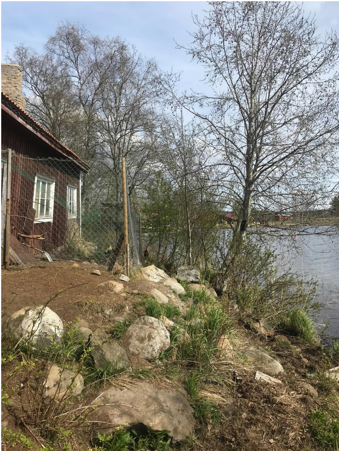
Bild 1 Befintlig byggnad med både lutande och rak del, samt befintligt fyllning med block och sten
